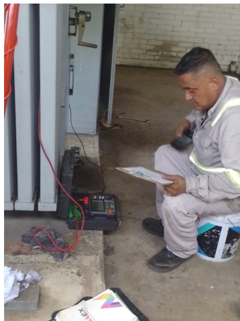
Medición de voltaje
