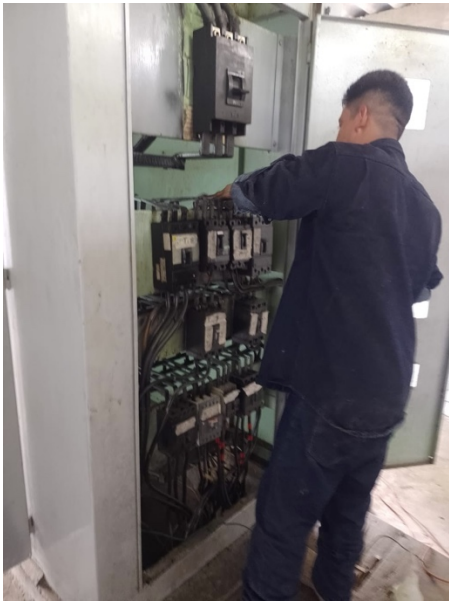
Revisión de circuitos secundarios
