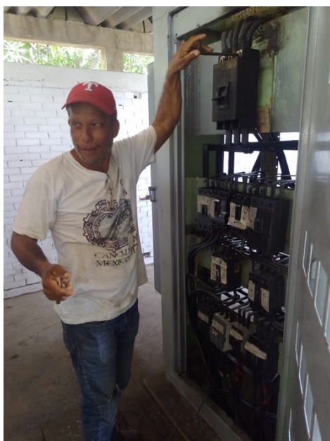
Revisión de centro de carga y break
